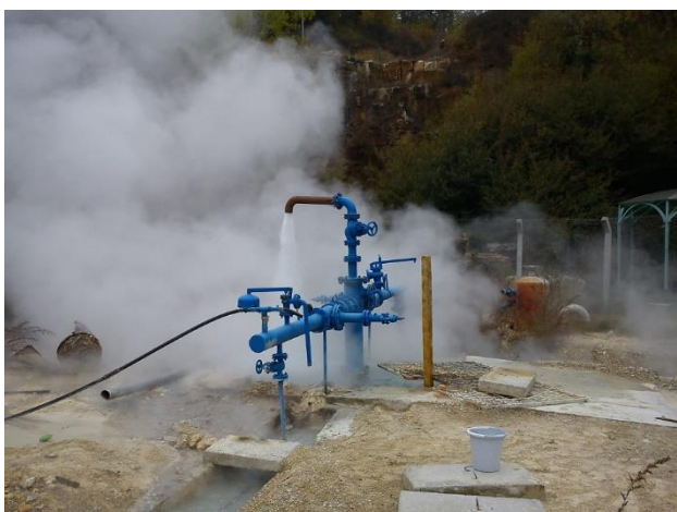
Slika 5. Bušotina sa termalnom vodom temperature 72 °C u Sijarinskoj banji
